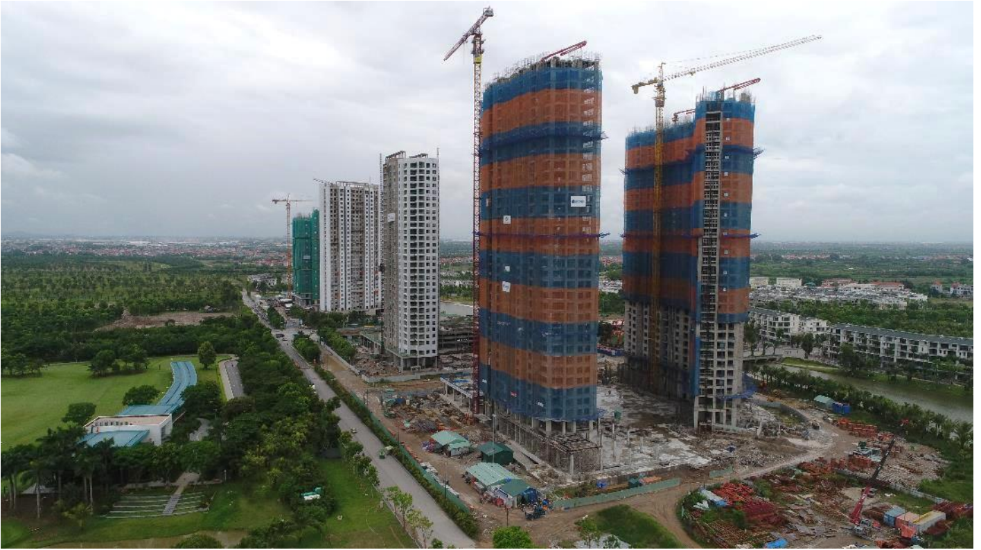
Tháp Lake 1 đã đổ sàn tầng 35, dự kiến sẽ cất nóc vào ngày 05/08/2018. Bên cạnh đó, tháp Lake dự kiến cất nóc 15/08/2018.
